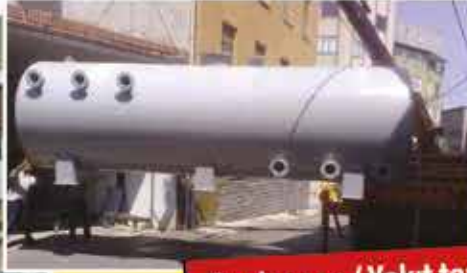
Su deposu / Yakıt tankı
